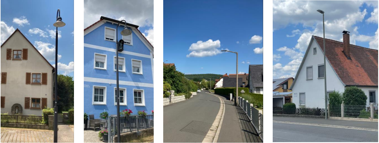
Abb. 38: Umstellung auf LED-Straßenbeleuchtung im Quartier. Quelle: DSK 2022
