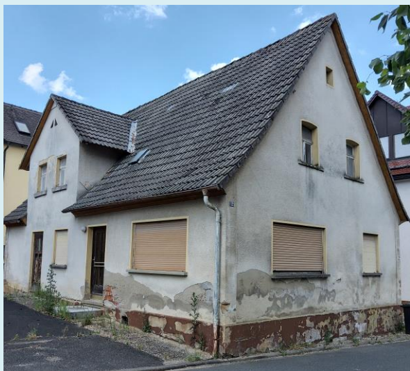
Abbildung f: Gebäude mit Substanzverlust in der Straße zur Ehrenbürg
